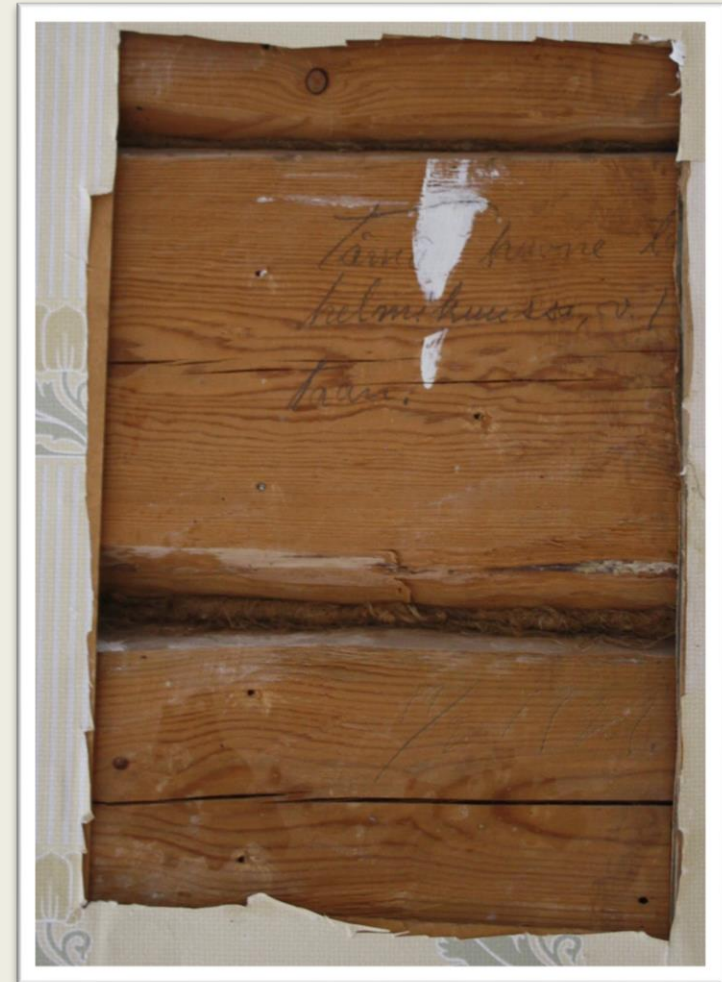
Kuva 6 Yläkerran aulan hirsipinnan terveiset rakennusvuodelta 1926
