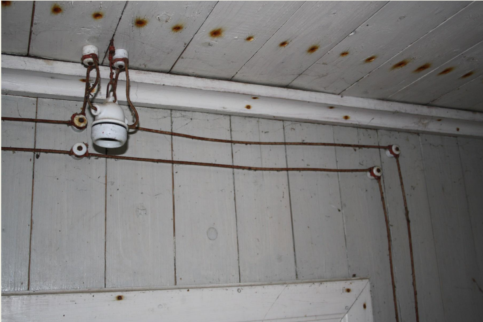
Kuva 34 Ulkokäymälä on säilynyt alkuperäisessä asussaan myös sähköistykseltään. MRT/2019.
